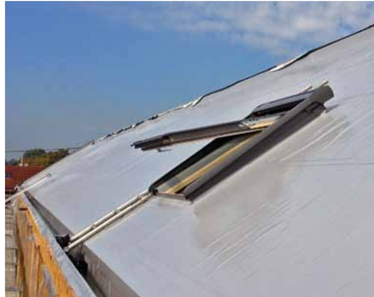
Nach der Montage der Dachelemente wurde eine Folienabdichtung aufgebracht, darauf die Unterkonstruktion für die Photovoltaik-Module
