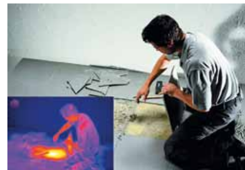
Auch Leckagen im Estrich kann man auf die Spur kommen und Reparaturbereiche eingrenzen
