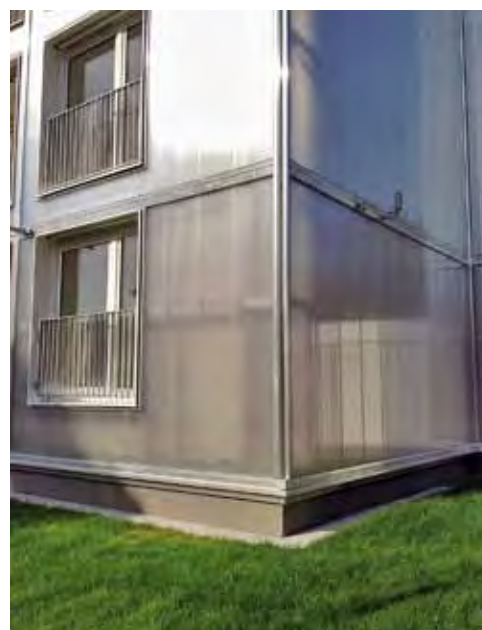
Fassadendetail mit Zuluftauslass zum Speicher - Punkthaus Mannheim, Energiekonzept: Fondation Kybernetik, TU Darmstadt
