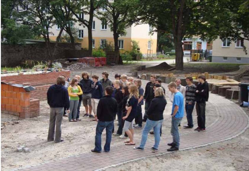
Auch Öffentlichkeitsarbeit gehört zum Projekt: Schüler besichtigen die noch im Bau befindlichen Pflanzenfilteranlagen.
