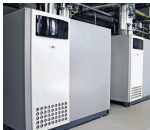
Zusätzlich zum Blockheizkraftwerk wurden zwei Wolf-Gas-Brennwertkessel MGK 250 in Kaskade verbaut
